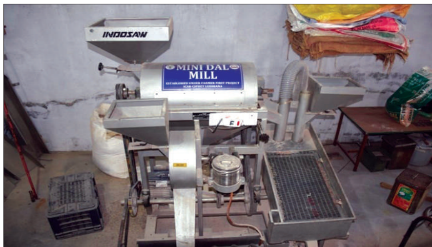
Installed Mini dal Mill
